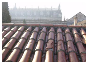
Figura 2 - Falta de ventilação
