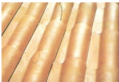
Figura 1 - Telha deslocada ou partida
