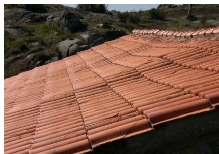
Figura 4 - Deformação da estrutura
