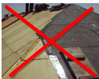
Figura 23 - Aplicação incorreta de tela por cima de painel Ondutherm
