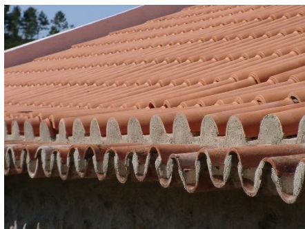
Figura 3 - Incorreta aplicação dos materiais
