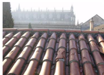
Figura 2 - Falta de ventilação
